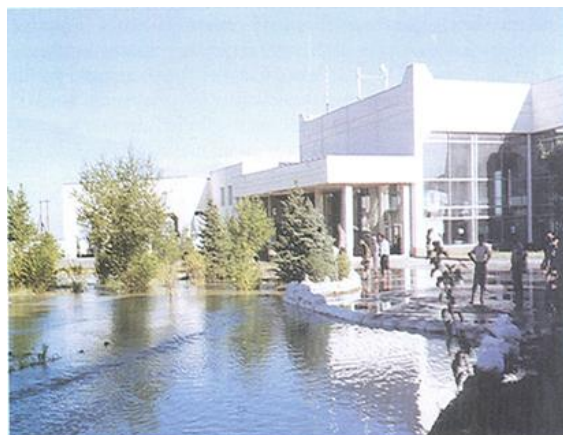
Рис. 4. Размыв верхового откоса берегоукрепительной дамбы в июне 2010 года в районе МЦПС.
