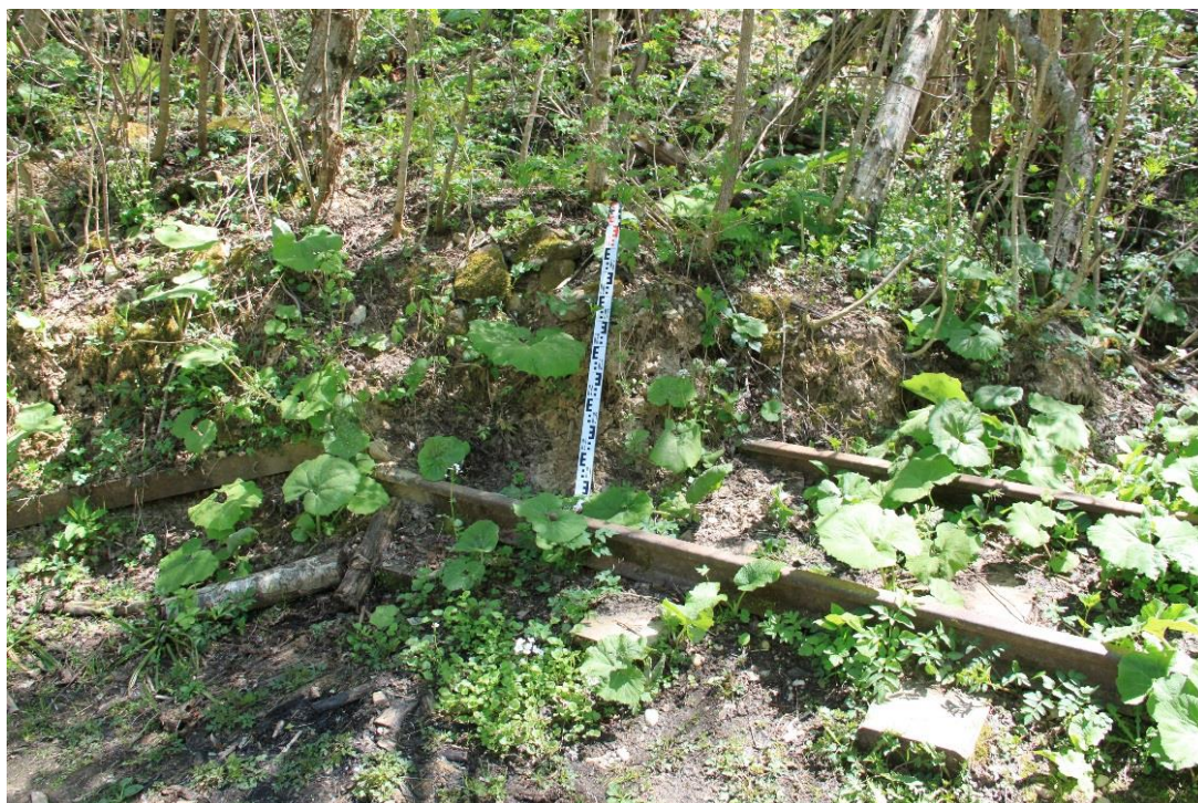
Рис. 4. Полотно узкоколейной железной дороги в Гуамском ущелье р. Курджипис было уничтожено оползнем. Фото Д. Шулякова, апрель 2018 г.
