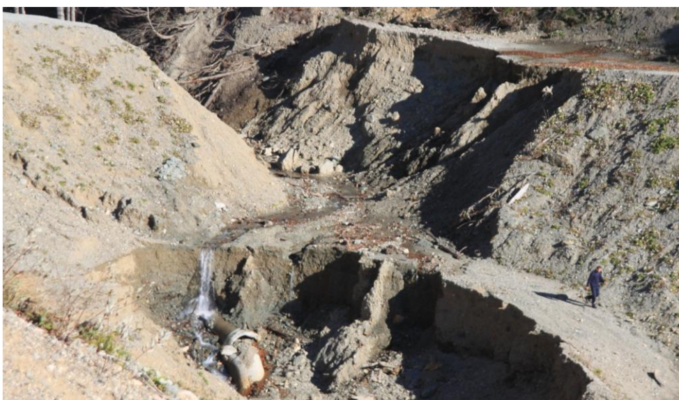
Рис. 3. Разрушенная селевым потоком автомобильная дорога в верховьях р. Пшеха. Фото Д. Шулякова. Сентябрь 2011 г.
