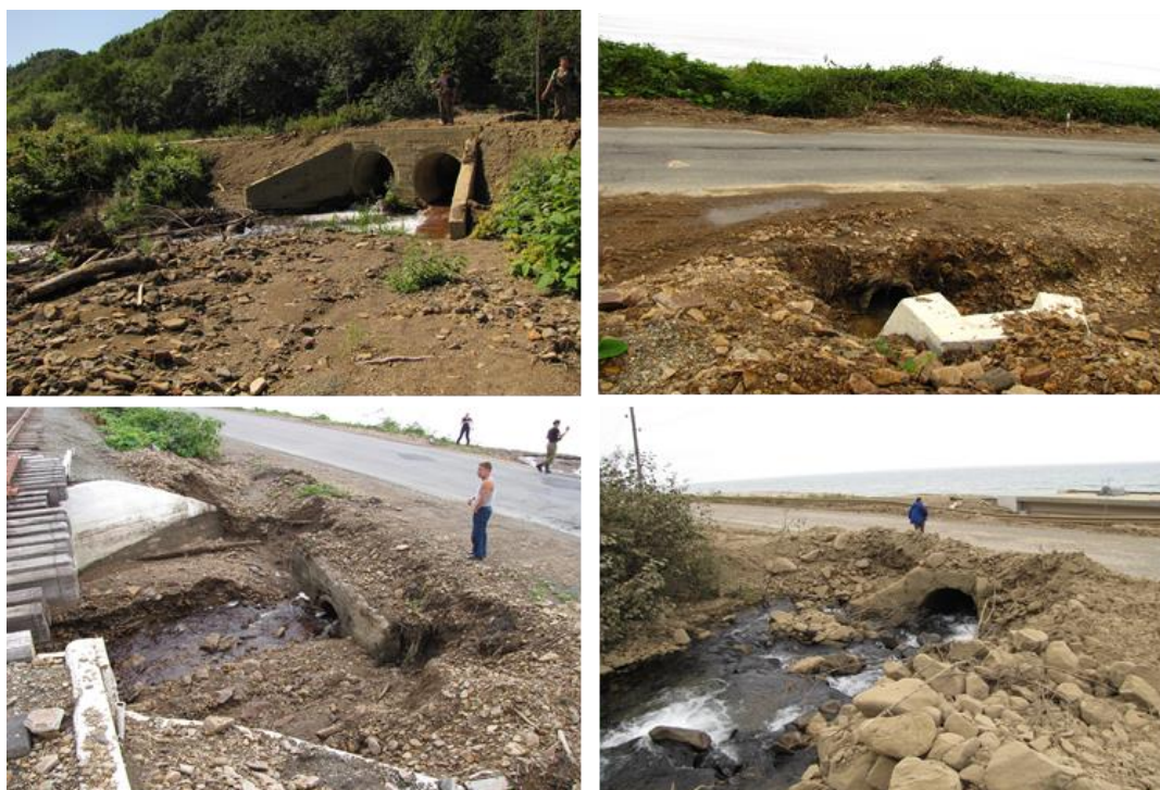
Рис. 3. Водопропускные трубы на селевых ручьях о. Сахалин: фото а) и г) – юго-восточное побережье, Макаровский район; фото б) и в) – юго-западное побережье, Невельский район
