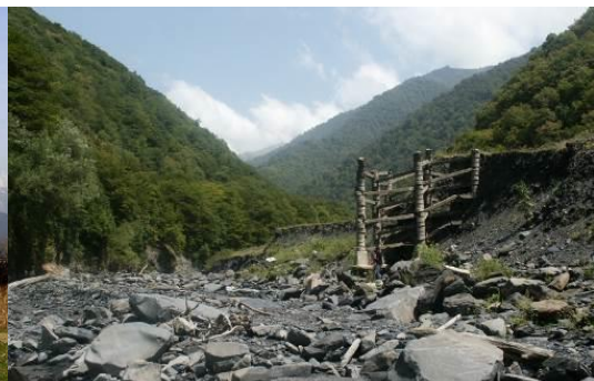
Разрушенная селезащитная плотина на реке Дуруджи выше города Кварели.
