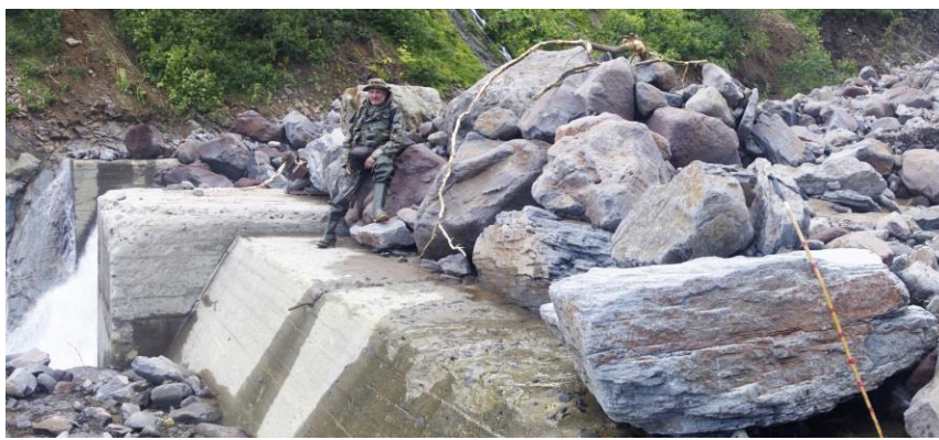
Рис. 11. Плотина, заваленная глыбами до 2 м в поперечнике. Фото Т.А. Котенко.
