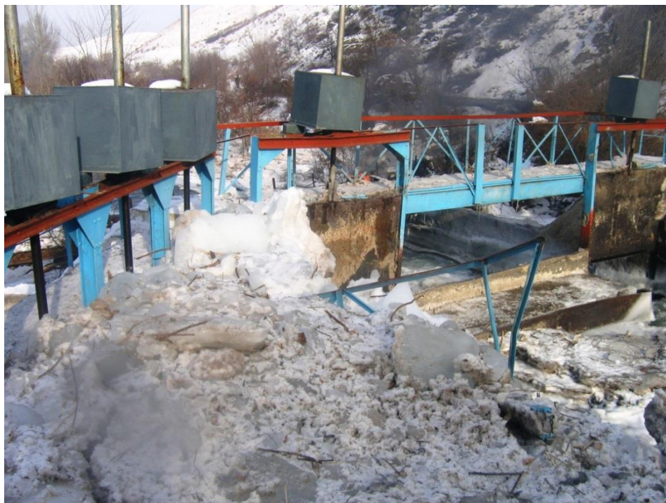
Рис. 1. Мост, разрушенный водоледовым селем в 2006 г. Фото Яфязовой Р.К., сделанное во время обследования
