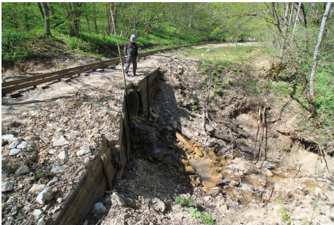
Рис. 5. Неправильное техническое решение при восстановлении железной дороги привело к размытию ее полотна. Фото Д. Шулякова, апрель 2018 г.
