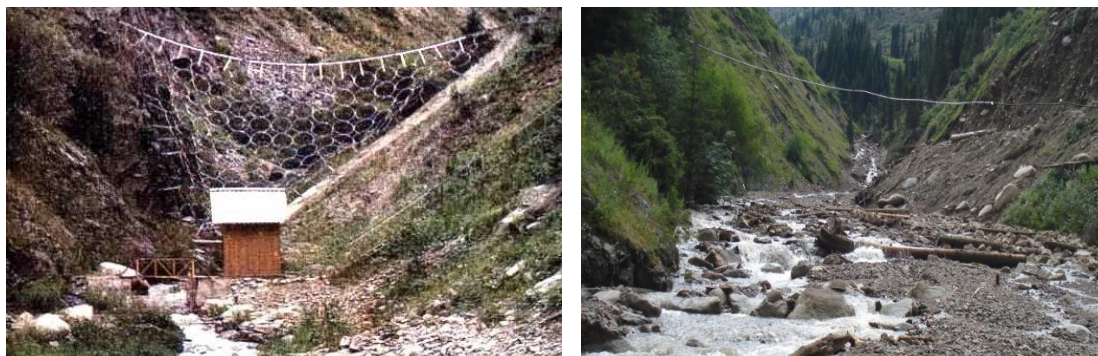
Рис. 5. Селезащитное тросово-сетчатое сооружение до и после селевого потока в 2013 году
